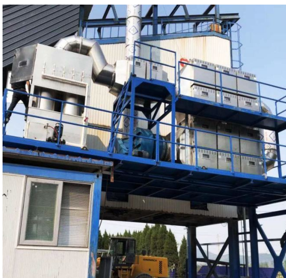
Централизованная система пылеудаления на промплощадке
