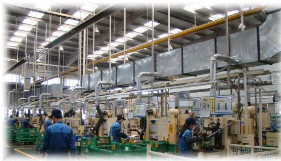
ABL-LTV — вакуумные инфракрасные трубчатые излучатели под кровлей цеха
